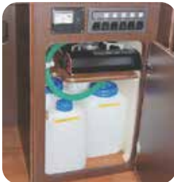
水タンク(各10ℓ×2) サブバッテリー残量計 6連集中パネルスイッチ
